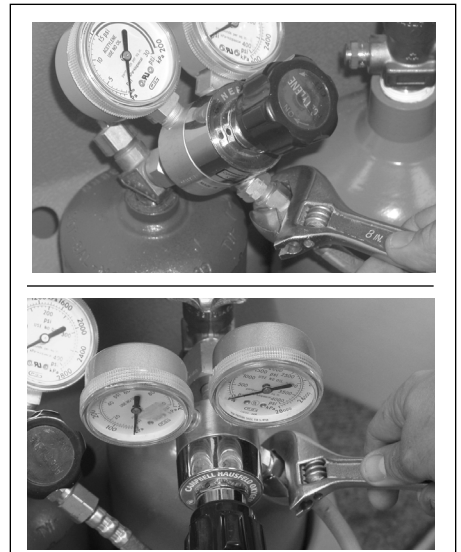
Figura 3 - Conexión de acetileno (arriba) y conexión de oxígeno (abajo)
